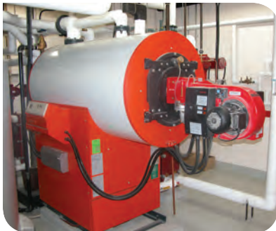
■ Egy többlakásos épület fűtését biztosító kondenzációs gázkazán
